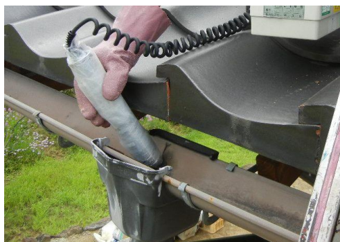
軒樋の集水器
