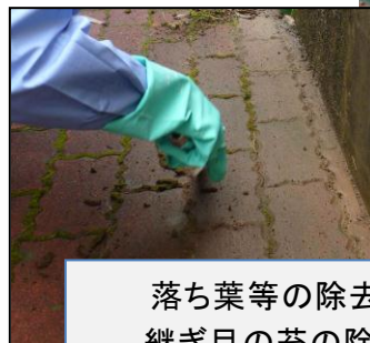
舗装割れ目 の草等の除去
