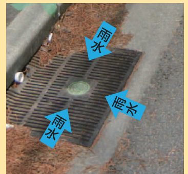
雨水で道路脇に落ち葉や土砂が堆積している例
