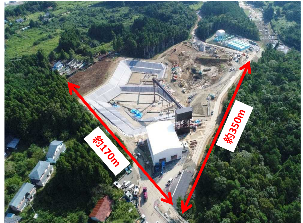
土壌貯蔵施設 (貯蔵容量: 約23万 \text{m}^3 )
