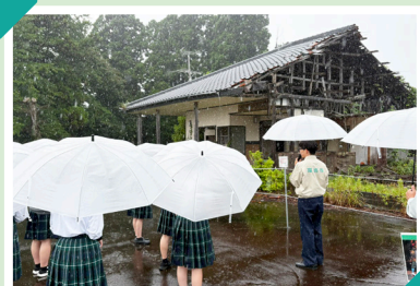
津波で半壊した 熊川公民館
