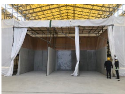
中間貯蔵施設区域（大熊町） テント内の軟化処理設備
