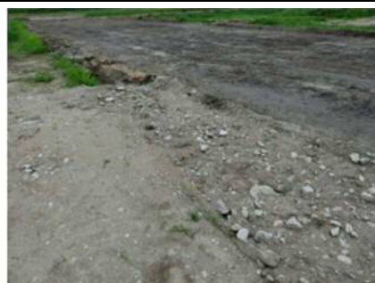
石礫飛散状況
