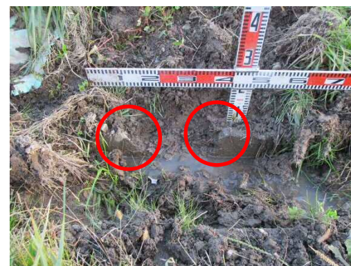
イノシシによる用水路破損 不規則に割れ、破片が用水路に散在
