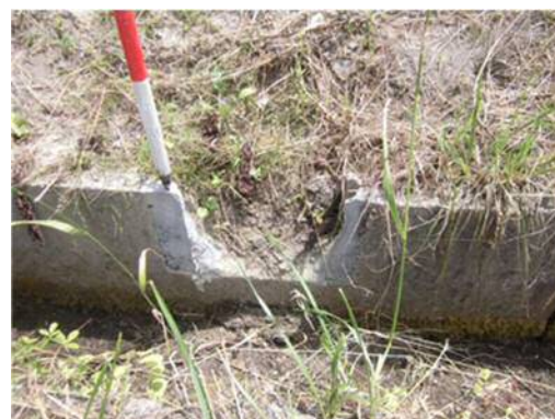
仮排水溝設置による欠損
