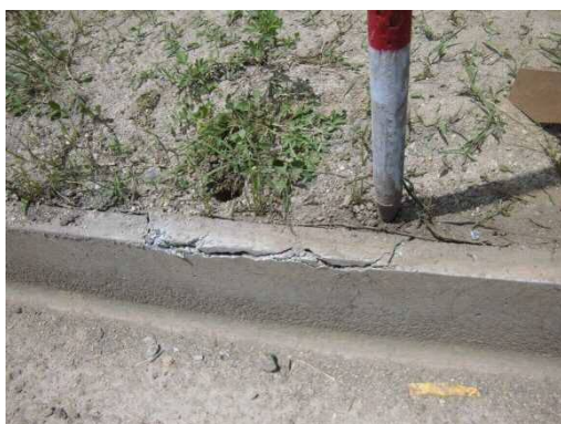
重機荷重による破損
