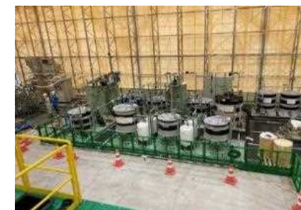
その2事業者：実証試験設備
