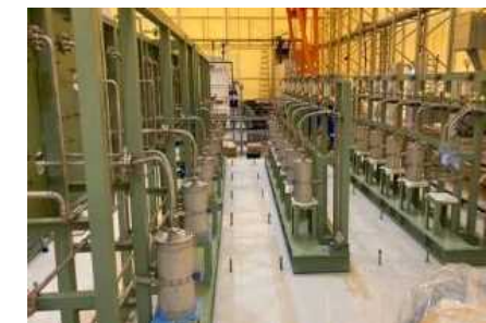
その1事業者・吸着設備
