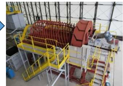
沈降分離により、砂と粘土・シルトを分別し、主に「砂」を回収する設備
