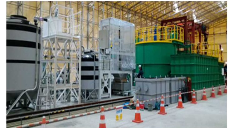
洗浄工程設備
