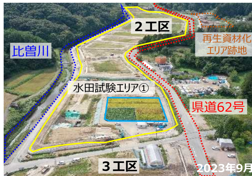
飯舘村長泥地区における農地造成実証事業 (環境再生事業)現場2工区、3工区農地盛土造成状況
