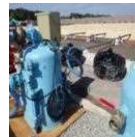
浸透水の集水設備の概観
