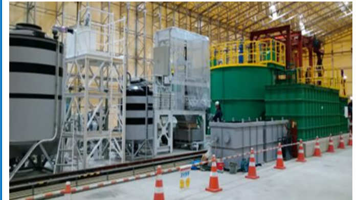
洗浄工程設備
