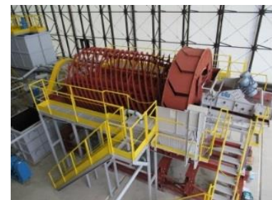
沈降分離により、砂と粘土・シルトを分別し、主に「砂」を回収する設備
