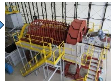
沈降分離により、砂と粘土・シルトを分別し、主に「砂」を回収する設備
