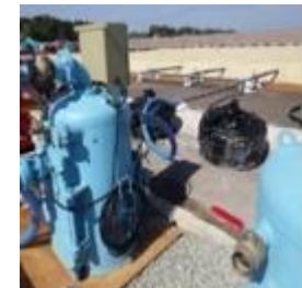
浸透水の集水設備の概観
