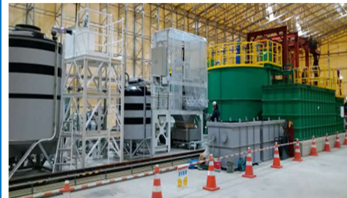
洗浄工程設備
