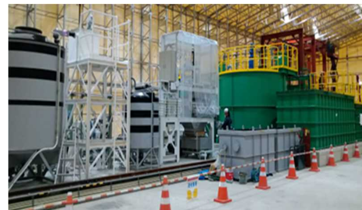
洗浄工程設備
