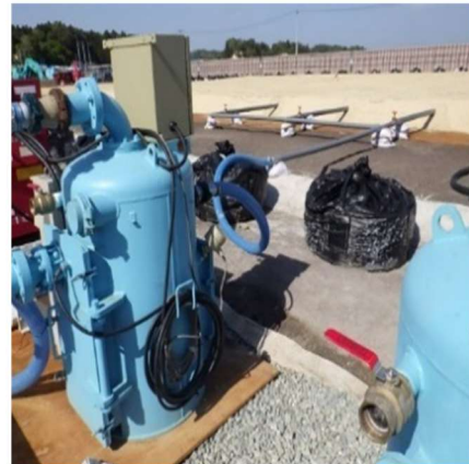
浸透水の集水設備の概観
