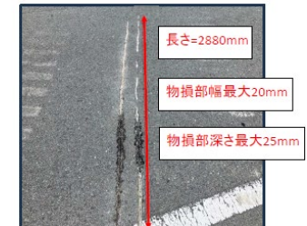
【県道の損傷状況】
