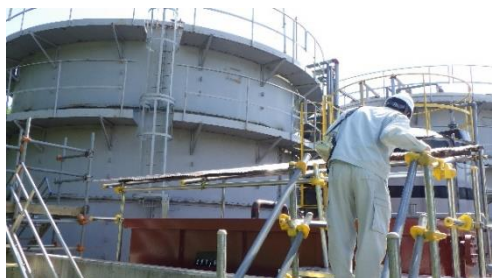
土壌貯蔵施設（浸出水処理施設）の状況
