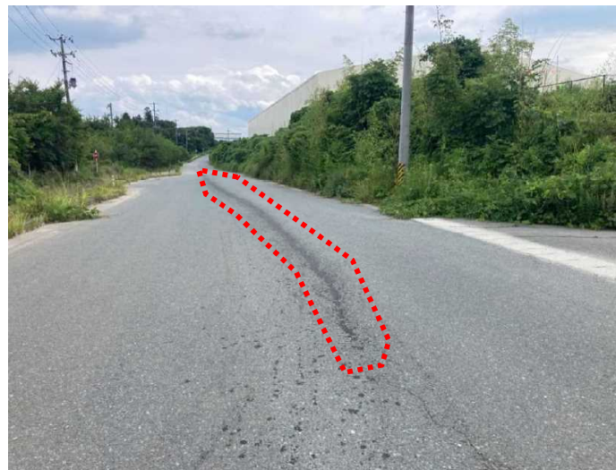
【油漏れ状況県道391号線】
