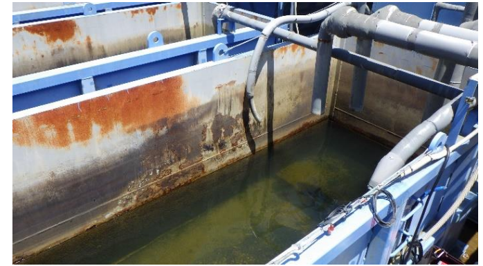
浸出液処理水槽
