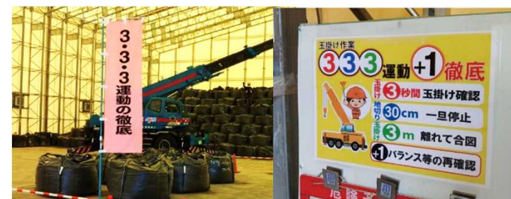
【事故後に設置した掲示物の例】
