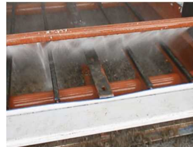
解泥後の土壌に水をかけながら、ふるいを振動させることで、主に「礫」を回収する設備
