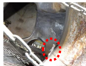
仮設灰処理施設(その2)損傷状況
