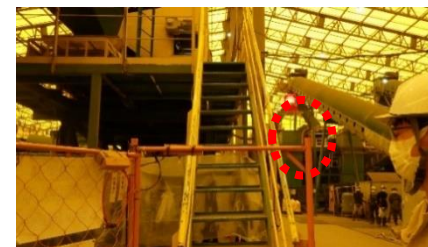
ガードフェンス解錠時におけるパトランプ点灯状況
