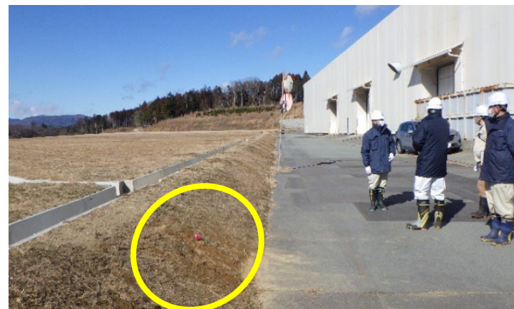
遮水シート損傷箇所（1月31日）
