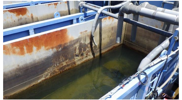
浸出液処理水槽
