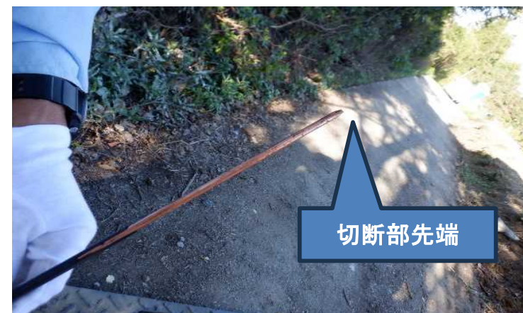
【切断された架空線】
