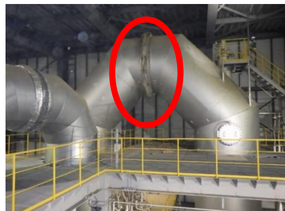
伸縮継手の損傷 （仮設焼却施設その1）
