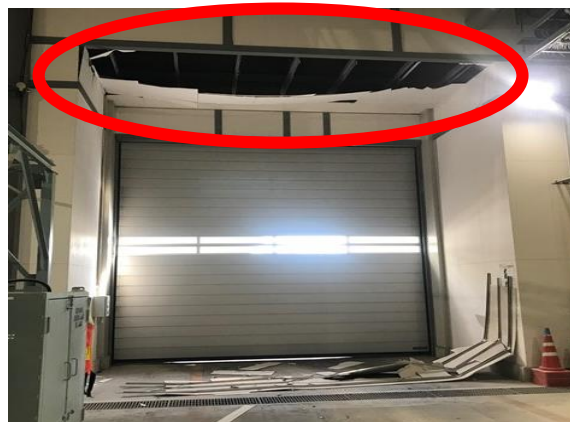
シャッター前の天井の損傷 （仮設灰処理施設その2）
