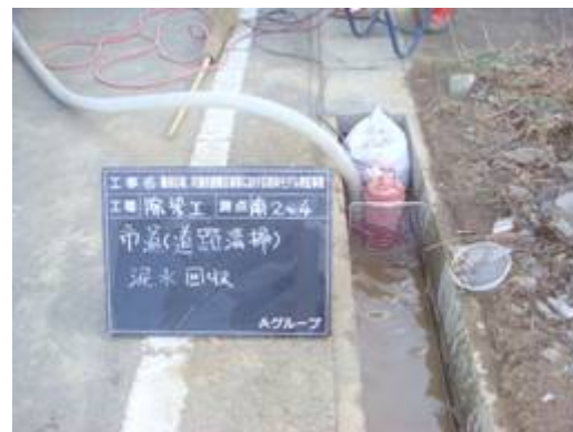
同左回収ポンプ
