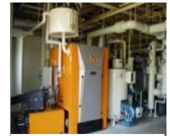
熱供給施設等での利用
