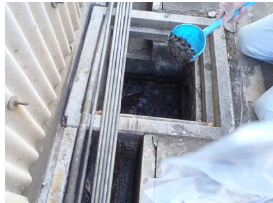
図3(2) 雨水枡の泥溜まりでの濃集(蓄積)
