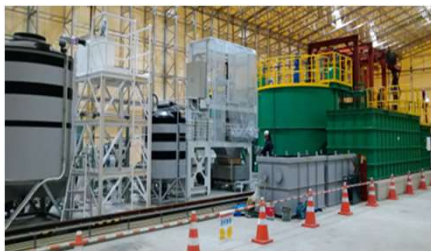
洗浄工程設備
