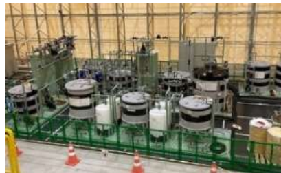
吸着工程設備 (3設備のうち1設備)
