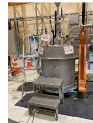
安定化工程設備 (3設備のうち1設備)
