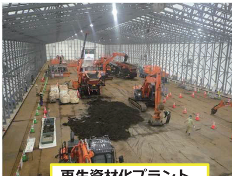
再生資材化プラント
