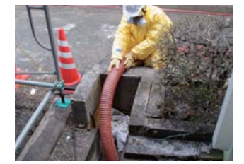
雨水枡・側溝 除染に使用した水の排水処理
