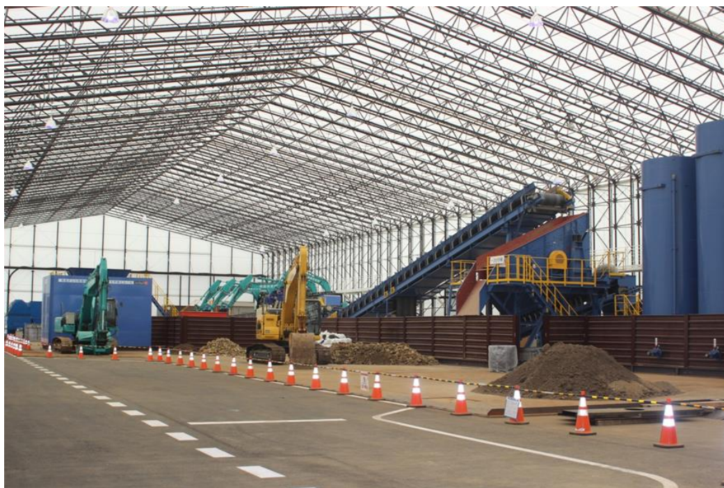
受入・分別施設(1期大熊工区) (処理能力 140t/h)
