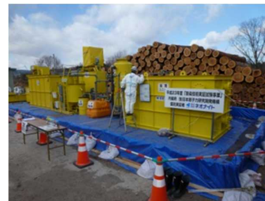
除染設備全体
