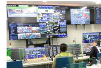
集中監視室の様子
