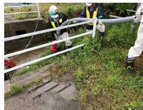
⑤用水ポンプ設置状況
