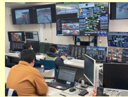
集中監視室内状況
