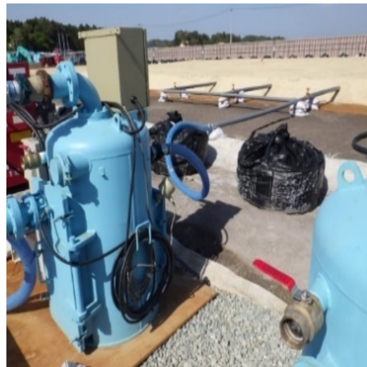
浸透水の集水設備の概観
