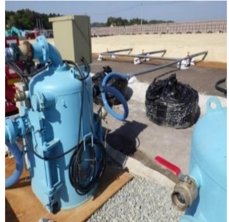
浸透水の集水設備の概観
