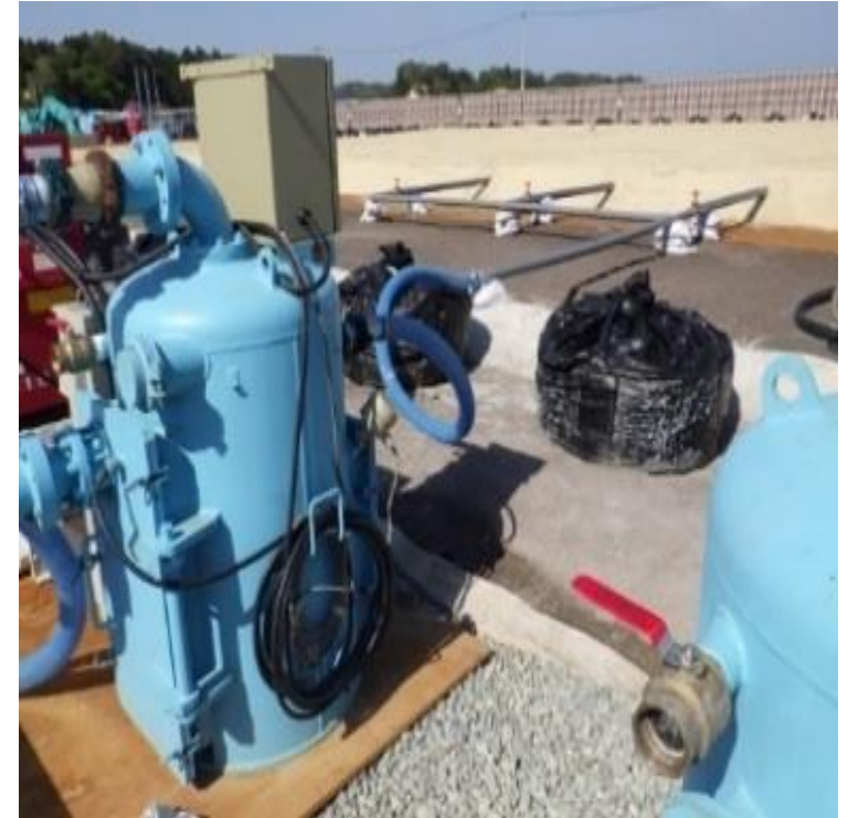
浸透水の集水設備の概観
