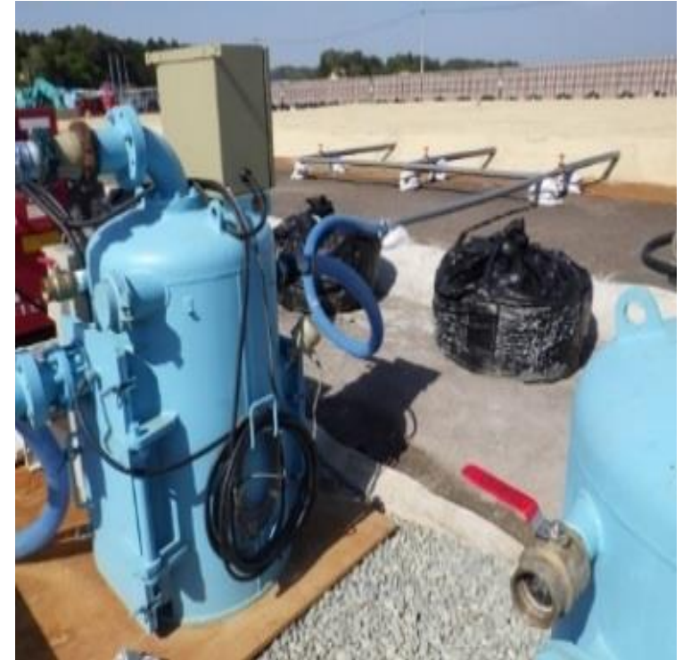
浸透水の集水設備の概観
