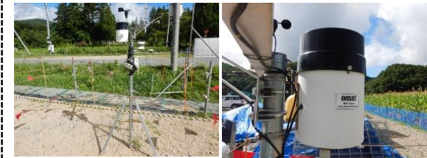
設置状況（水田エリア①） 雨量センサー
