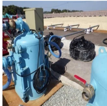
浸透水の集水設備の概観
