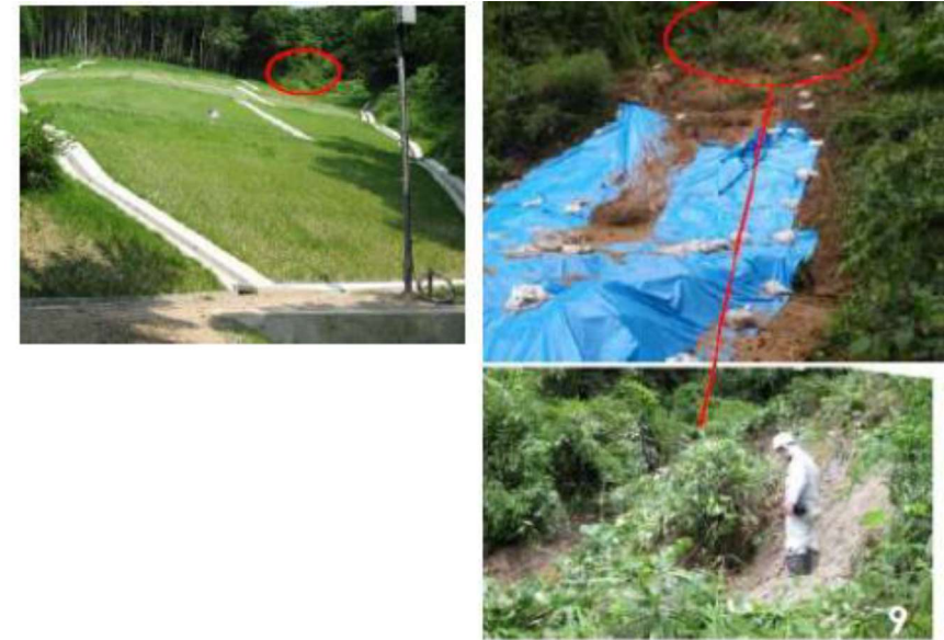
豪雨前後の変状 2)
