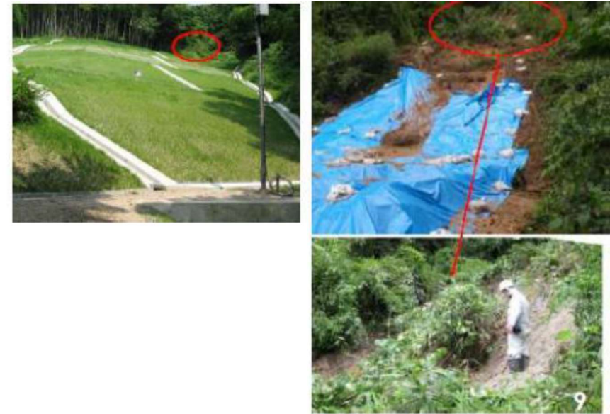
豪雨前後の変状 2)
