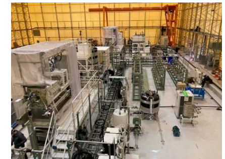
その1事業者・吸着設備
