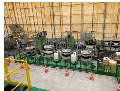
その2事業者:設備全体
