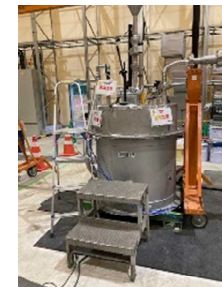
安定化工程設備 (3設備のうちの1設備)
