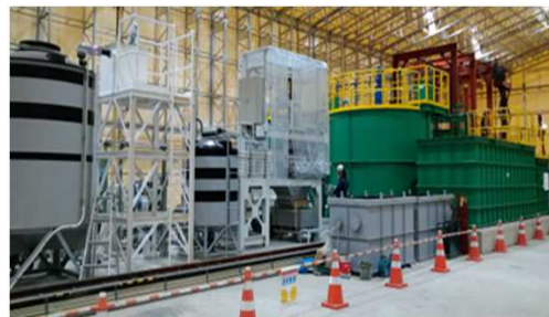
洗浄工程設備
