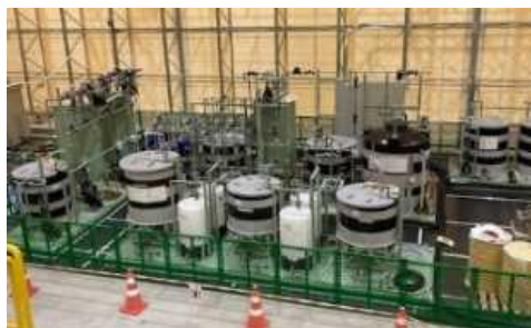
吸着工程設備 (3設備のうちの1設備)
