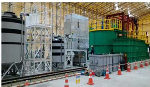
洗浄工程設備
