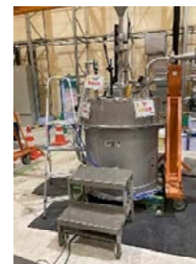
安定化工程設備 (3設備のうちの1設備)
