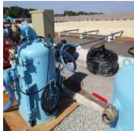
浸透水の集水設備の概観
