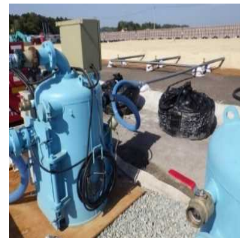
浸透水の集水設備の概観
