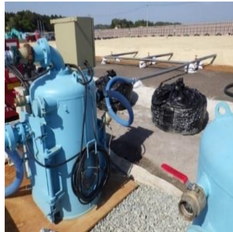
浸透水の集水設備の概観
