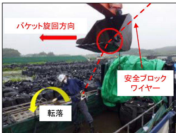
図 事故の発生状況
