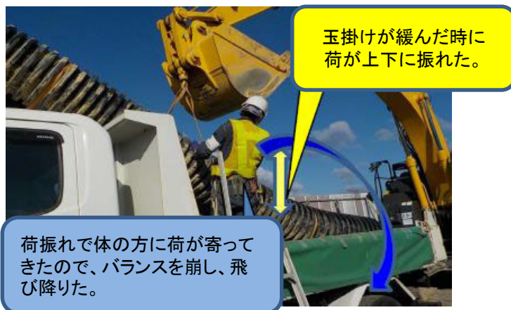
図 事故の発生状況
