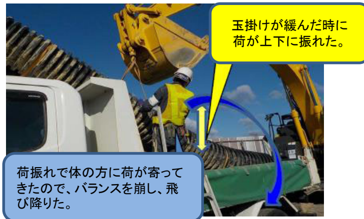
図 事故の発生状況
