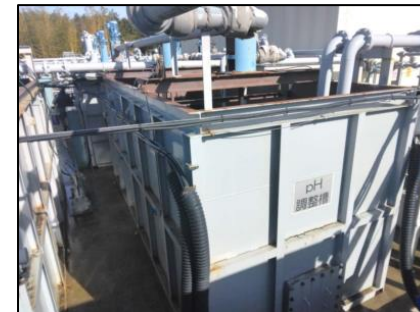
【PH調整槽外観】
