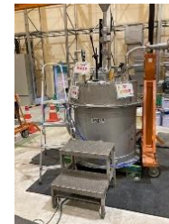
安定化工程設備 (3設備のうちの1設備)
