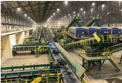
受入・分別施設(稼働中)
