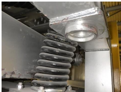
仮設灰処理 生成物コンベアの損傷
