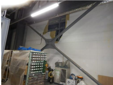
仮設灰処理 内壁脱落
