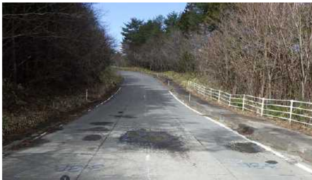
輸送後（道路補修前）の状況
